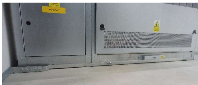
Fot. 3-14 Uziemięcie rozdzielnicy nN
