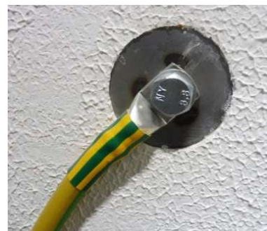
Fot. 3-33 Zacisk uziemiający (wyprowadzenie zbrojenia betonu).
