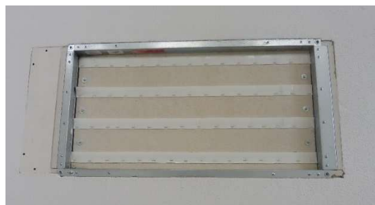
Fot. 3-39 Klapa przeciwpożarowa zamontowana w stacji
