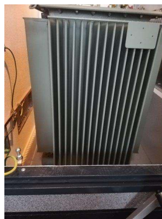
Fot. 3-12 Zamontowany transformator w stacji.
