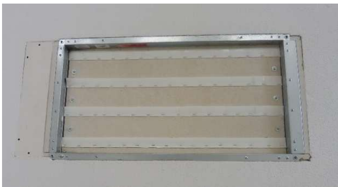
Fot. 3-48 Zamknięta klapa p.poż. zamontowana w stacji
