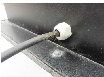
Fot. 4-46 Przewód zasilający transformator przeprowadzony przez dławik
