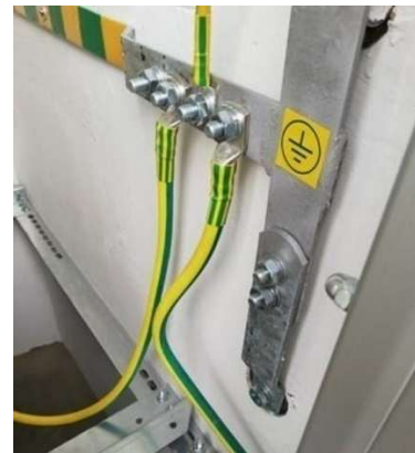
Fot. 3-20 Złącze kontrolne.
