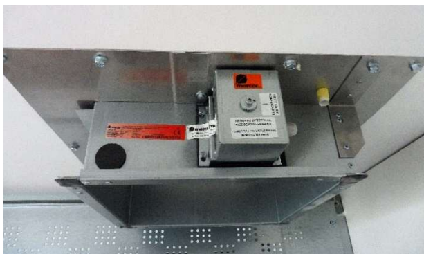
Fot. 3-41 Klapa p.poż. – widok z zewnątrz
