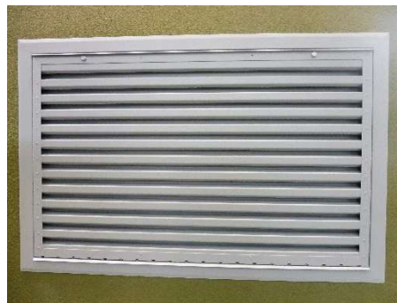
Fot. 11-10 Żaluzja z włókniną filtracyjną widok z zewnątrz stacji
