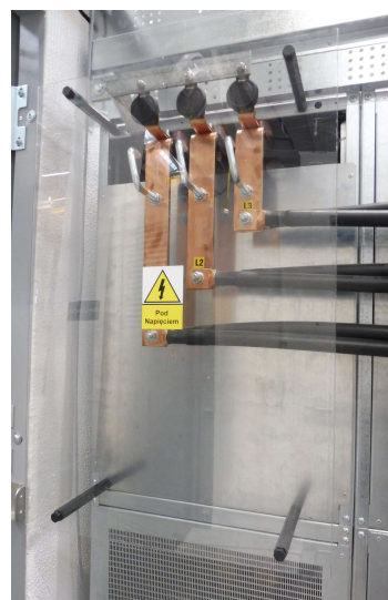
Fot. 5-11 Zamontowana szyna z ogranicznikami przepięć i maskownica toru szynowego
