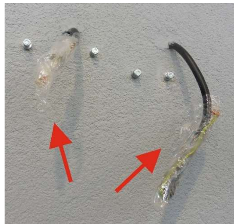
Fot. 4-10 Przewody zabezpieczone na czas transportu.
