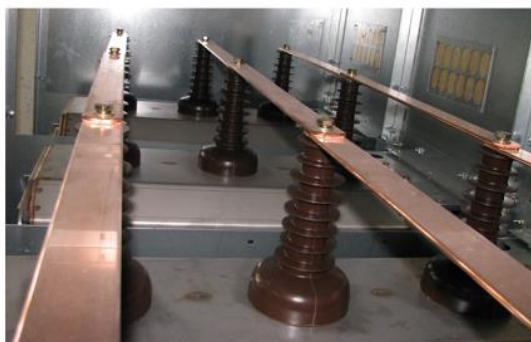
Fot. 1 Widok wnętrza przedziału szynowego.
