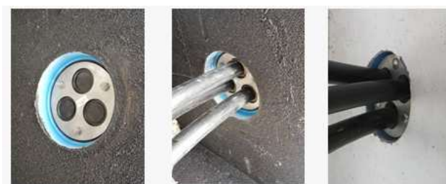
Fot. 6-2. Przykłady zamontowanych przepustów.
