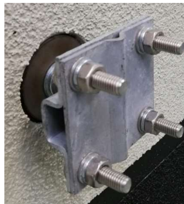
Fot. 3-32 Przepust uziemienia z przyłączem śrubowym widok z zewnątrz stacji.
