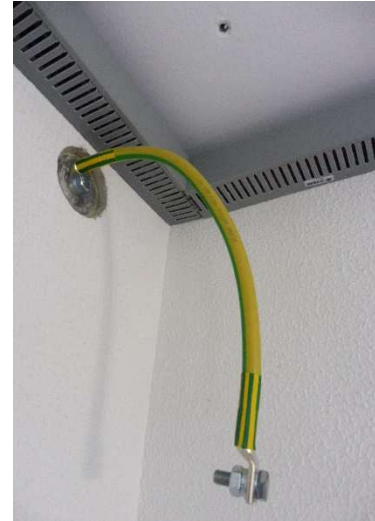
Fot. 3-19 Linka uziemiająca (uziemienie dachu i obudowy)
